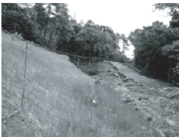
※2写真：5月下旬の大雨により土砂崩落した現場（クラフトパークから中之郷ブドウ団地に通じる道路）
